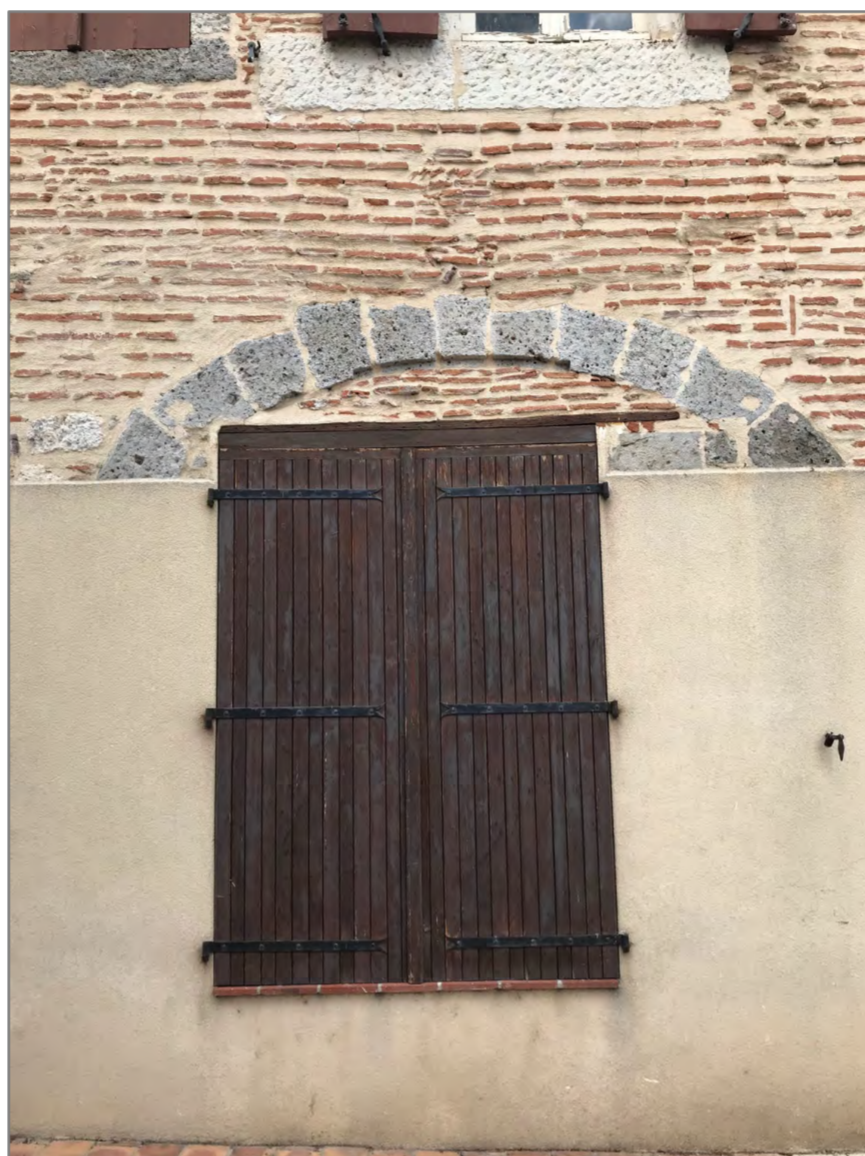
21 rue Gambetta, l'intervention du maçon aura été plus violente...
