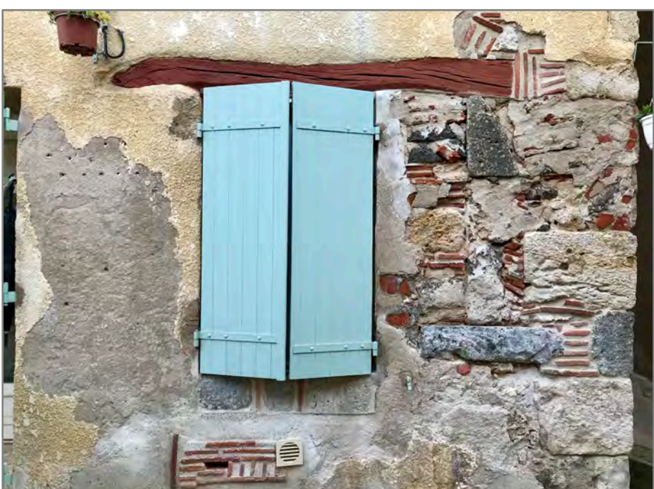
Rue Porte-Pinte, un remplissage désordonné qui était encore récemment protégé par un enduit...
