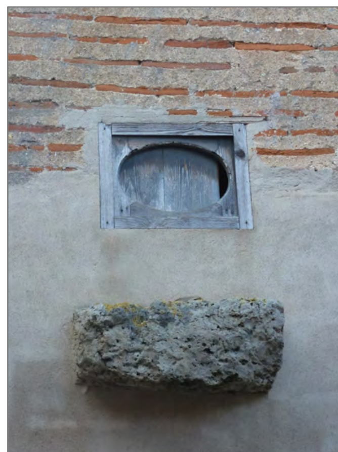
Simple et modeste, rue du Cheval-Blanc, composé de planches délavées par le temps.
