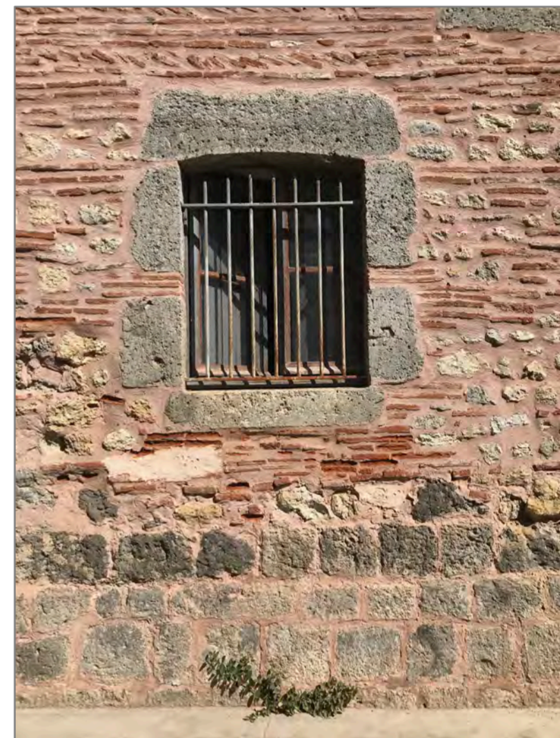
Rue des Chapeliers, ce mur rappelle la nécessité d'asseoir l'appareillage de briques sur une solide base de pierre. Celle-ci est également utilisée pour « tenir » l'ouverture.
